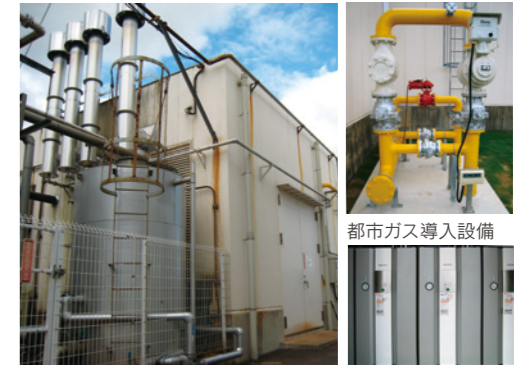
蒸気ボイラー建屋
