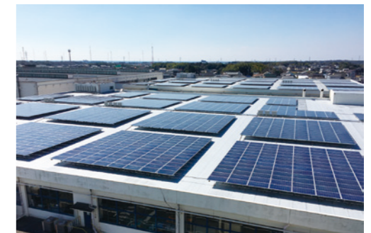
製品生産工場の屋上に設置した太陽光パネル
